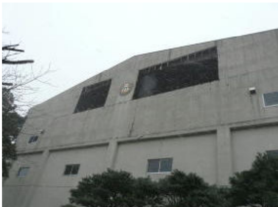
【校舎】体育館の壁が落ちました（↓）
