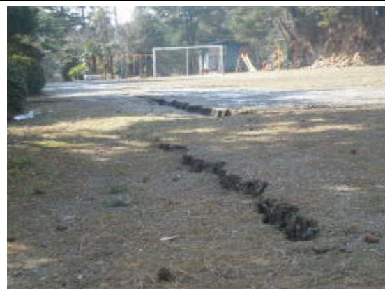
【校庭】各箇所地割れや地滑り発生
