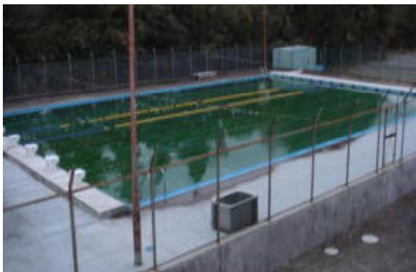
【プール】配管の亀裂で水が空っぽに (写真は改修後)
