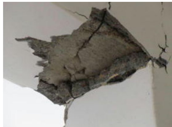
【校舎】何力所か壁の崩落も見られました
