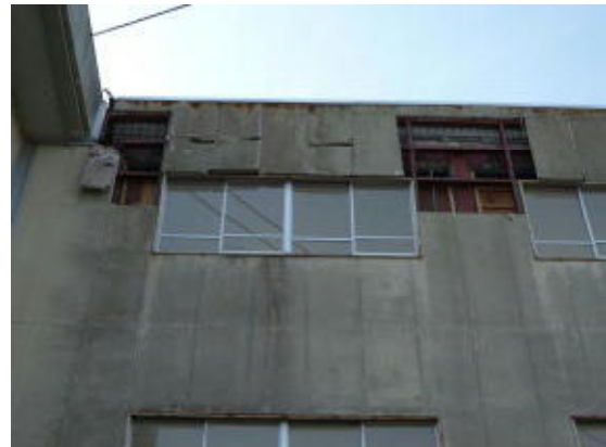
【校舎】通路の壁，崩落
