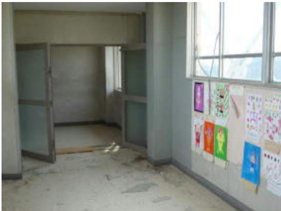
【校舎】ガラス破損，段差ができる
