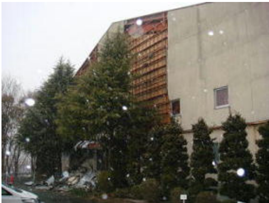
【体育館】外壁崩落。避難所は校舎内に
